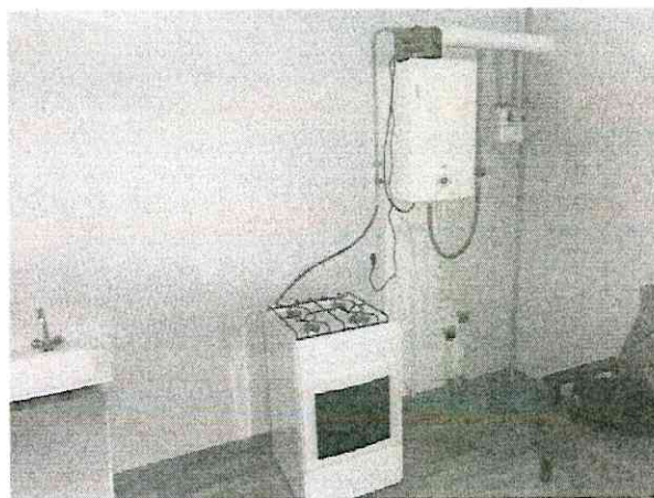
Оборудование помещения кухни
