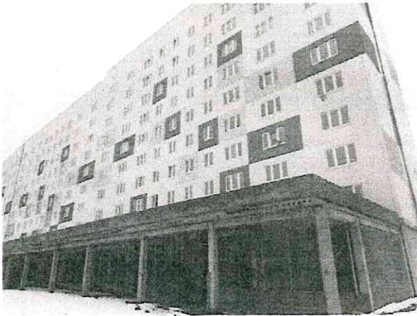
В доме по ул. Дементьева, 2, не закрыт тепловой контур здания
